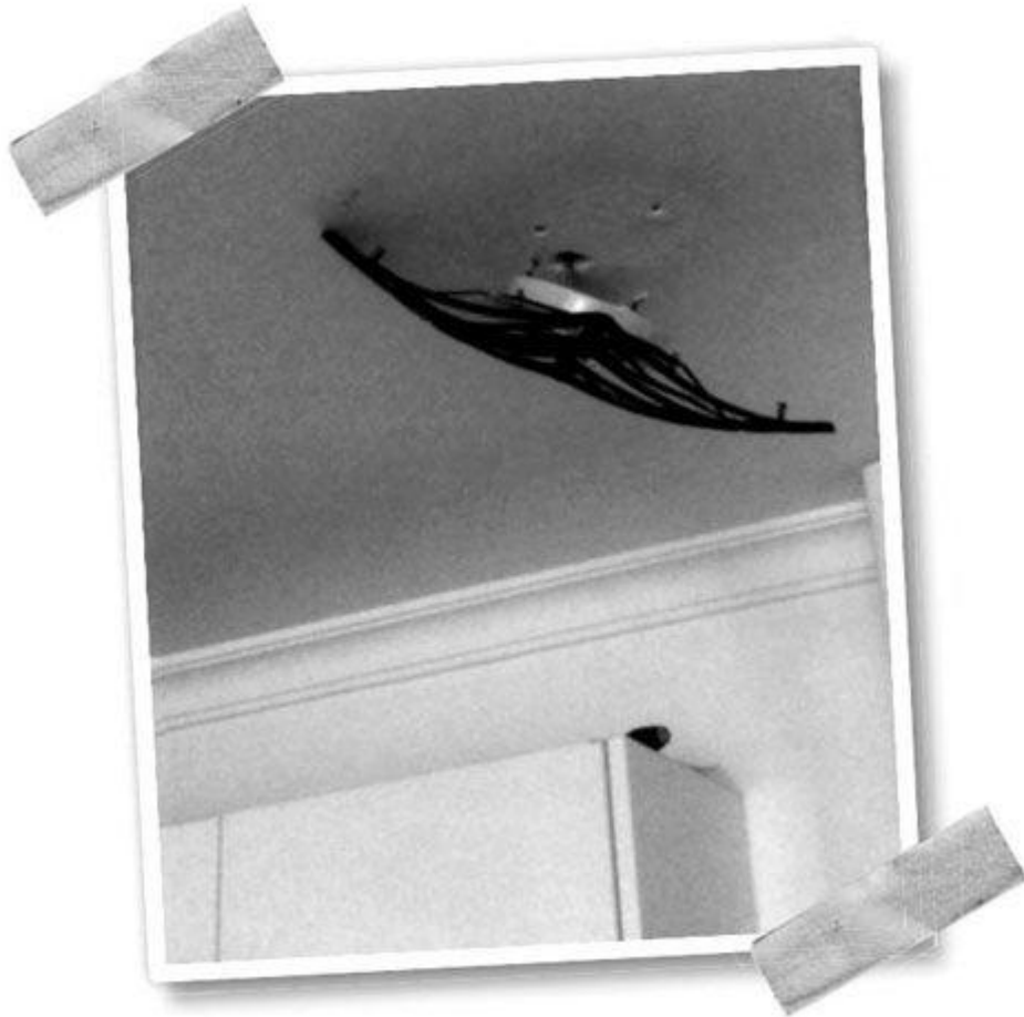
Plafón desprendido en el salón del apartamento de Agus. (Foto: Agus Aguirre).
